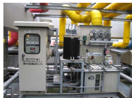
酸性ガス用排ガス浄化装置
