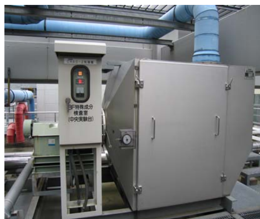
本部 屋上のスクラバ (排気ガス洗浄装置)
