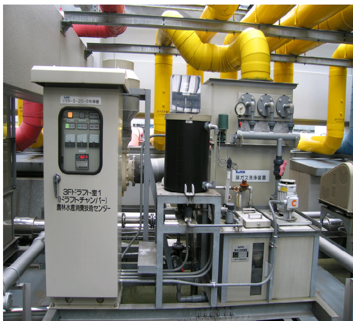
酸性ガス用排ガス浄化装置
