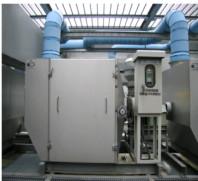
有機溶剤用脱臭装置
