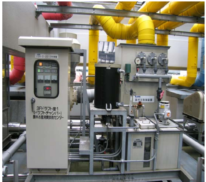
酸性ガス用排ガス浄化装置
