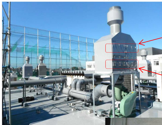
屋上設置のスクラバー(脱臭装置)
