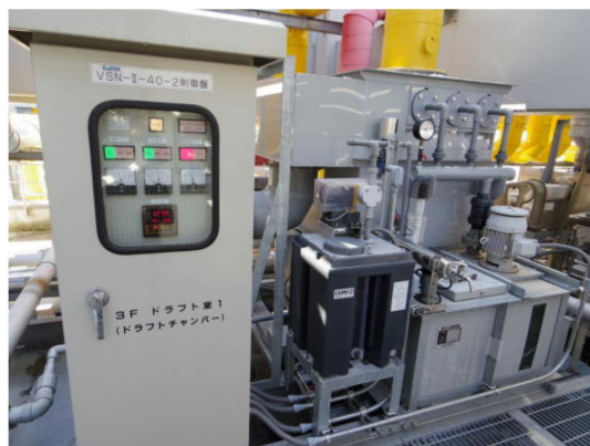
ガス洗浄装置(湿式スクラバー)
