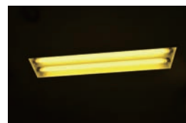
<遮光室で使用されている蛍光灯>
